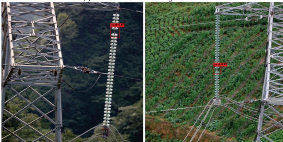
(d) Insulator tie wire loosening test results
