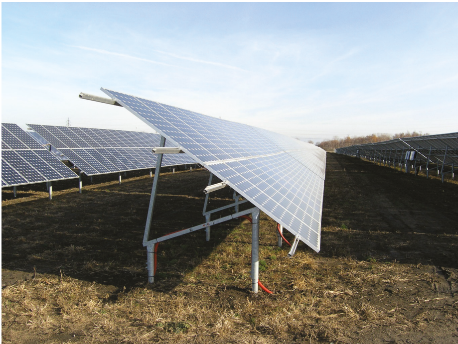
Figure 6. Photovoltaic array at Měnín.
